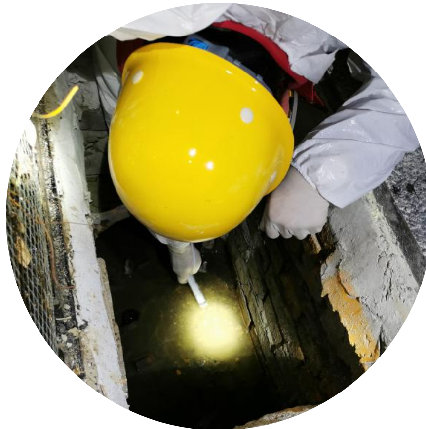
针对雨水沟内的水银， 则利用针管进行收集
